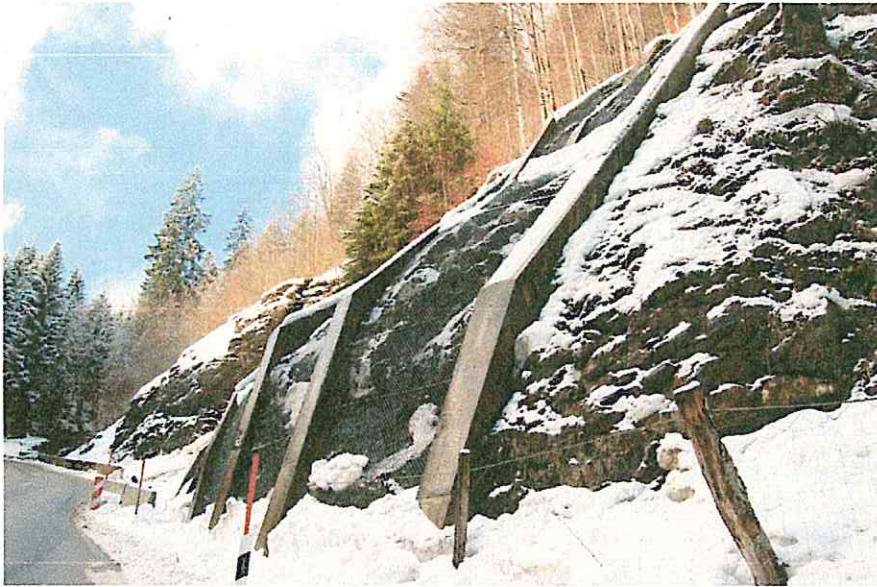
Abbildung 14: Zum Schutz der Riedbergpassstraße sind aufwendige Verbauungen notwendig (Quelle Frey)
